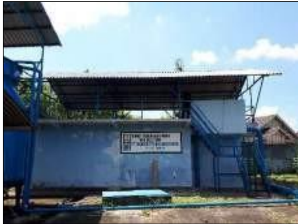
Gambar 3.39 IPA Dukong Pilang II
