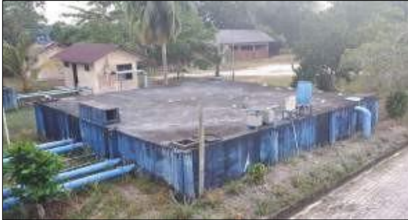
Gambar 3.42 Reservoir Air Serkuk I Kapasitas 200 m 3
