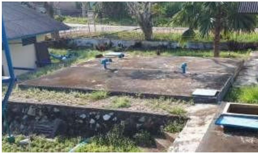
Gambar 3.46 Reservoir Dukong Pilang II Kapasitas 150 m 3
