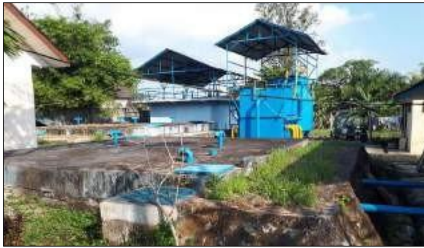
Gambar 3.45 Reservoir Dukong Pilang I Kapasitas 300 m 3
