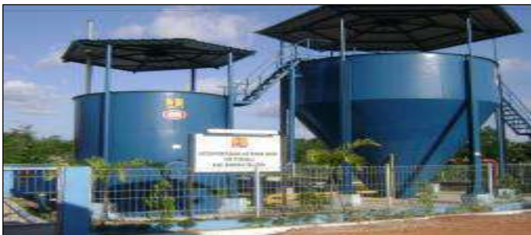
Sumber: Rencana Induk Sistem Pengolahan Air Minum (RISPAM) Kabupaten Bangka Selatan, 2015 Gambar 3-68 IPA SPAM Parit 9
