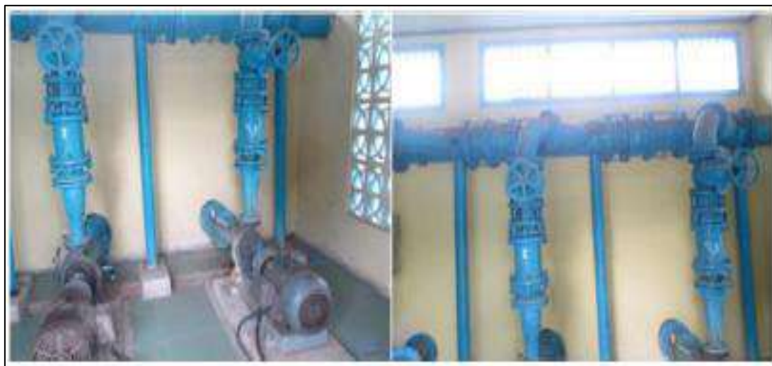
Sumber: Review Dokumen RISPAM Kabupaten Bangka Barat, 2021 Gambar 3-45 Pompa dan Water Meter Distribusi Cabang Terabek
