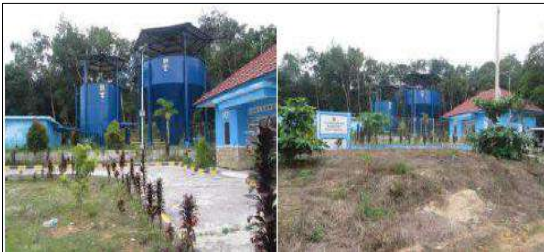
Sumber: Review Dokumen RISPAM Kabupaten Bangka Barat, 2021 Gambar 3-44 IPA Unit SPAM Terabek
