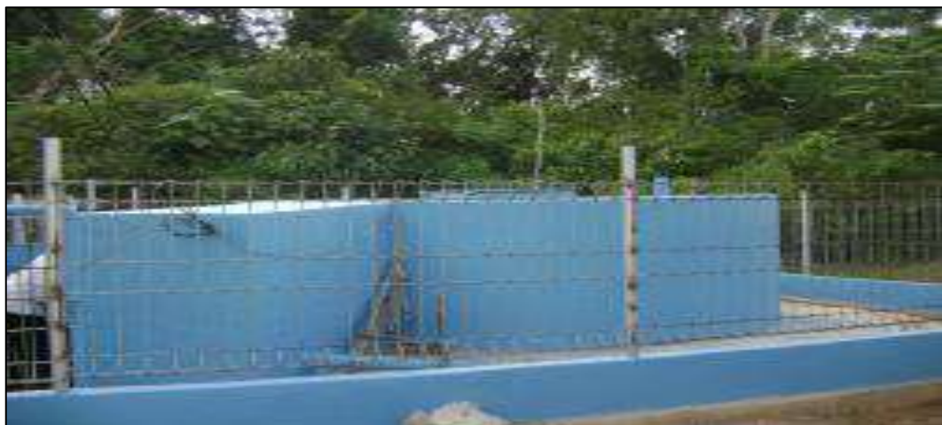
Sumber: Rencana Induk Sistem Pengolahan Air Minum (RISPAM) Kabupaten Bangka Selatan, 2015 Gambar 3-71 Sumber & Intake (Unit SPAM IKK Lepar Pongok)
